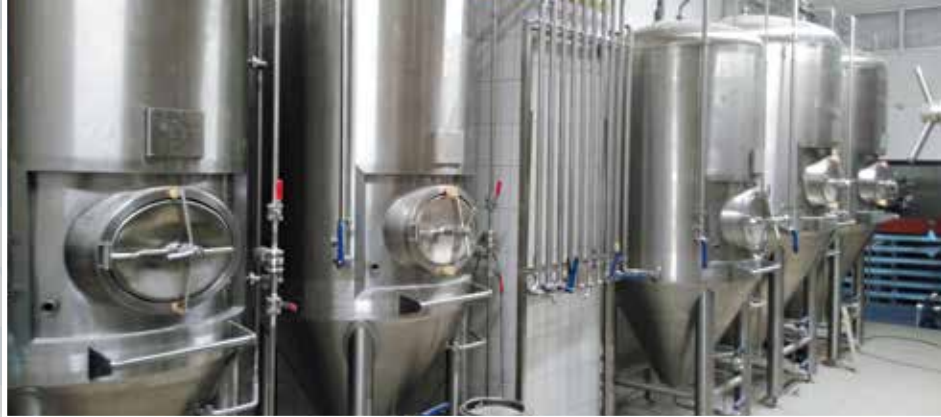
Blick auf die neuen Gärtanks
